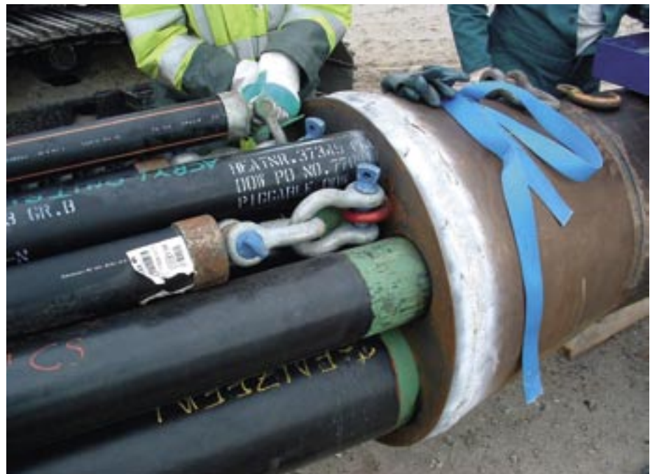
Rohrbefestigung am Masterzugkopf
