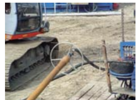
Pumpenanschluss an der Austrittsseite
